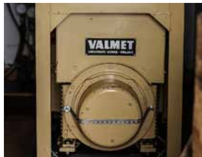
Dieser Generator wird seit 40 Jahren eingesetzt.
